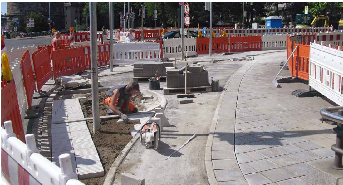
Eine deutliche Trennung zwischen Rad- und Fußweg macht den Bereich um den Rathenauplatz sicherer. Zudem gibt es nun ein Blindenleitsystem.
