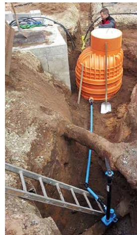
So sieht die Versorgung der Litfaßsäulen-Toilette unter der Erde aus.
