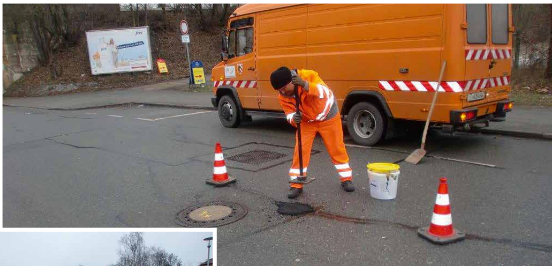
Kleine Schlaglöcher, die eine Gefahr für den Verkehr sind und schnell beseitigt werden müssen, entfernt der Bereitschaftsdienst.
