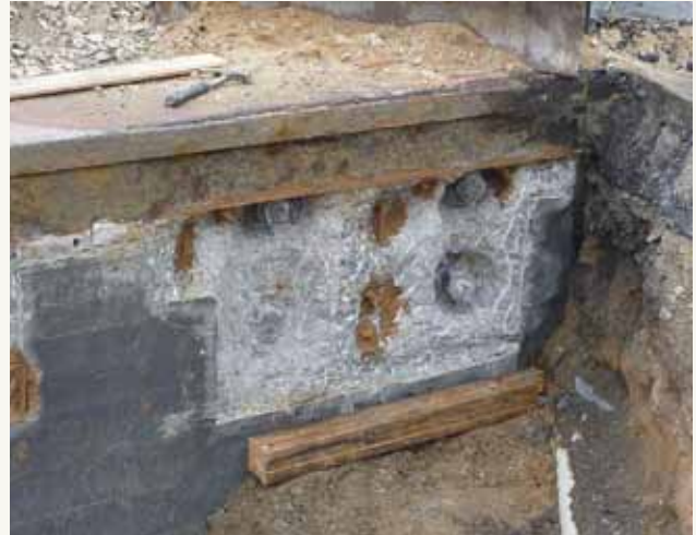
Überbauende mit freigelegten Spannköpfen zur Feststellung des Spannstahlzustandes
