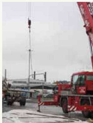
Des Weiteren musste die Verkehrsbeobachtungskamera auf der Otto-Brenner-Brücke und ihr 18 Meter hoher Mast während der Bauzeit zurückgebaut werden.
