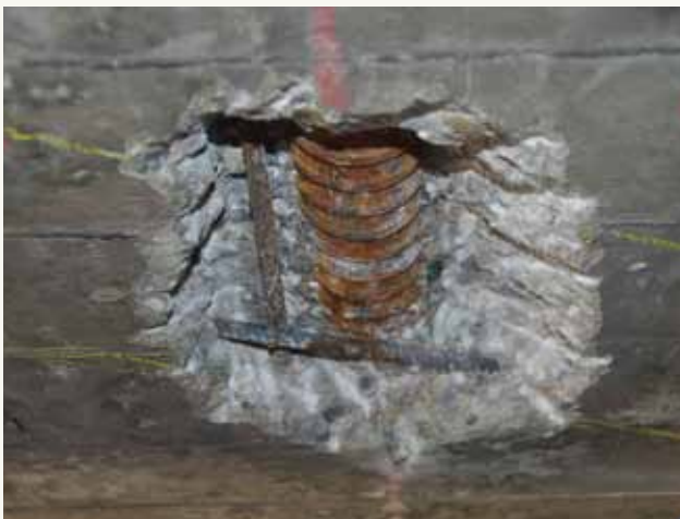
geöffnetes Hüllrohr mit freigelegtem Spannglied (Feldmitte, Brückenunterseite)
