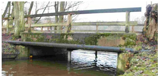
Baufälliges Brückenbauwerk mit Brückenunterstützung 2013
