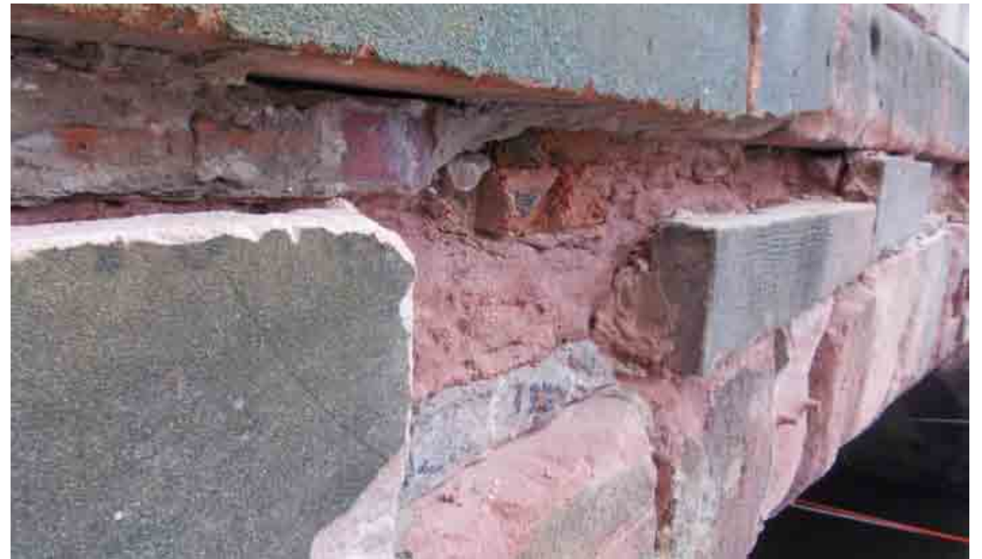
Die Untere Karlsbrücke vor der Sanierungen 2012. Die Schäden am Mauerwerk sind klar ersichtlich.
