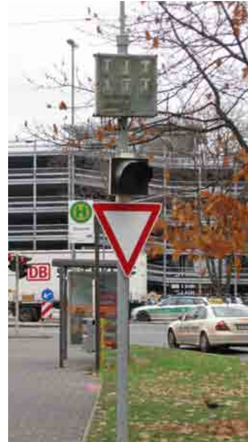
Ausgangszustand LSA Bahnhofstraße/Dürrenhofstraße, alter Relaiskasten
