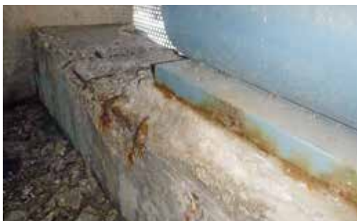
2. Ausgangssituation: undichte Übergangskonstruktion.
