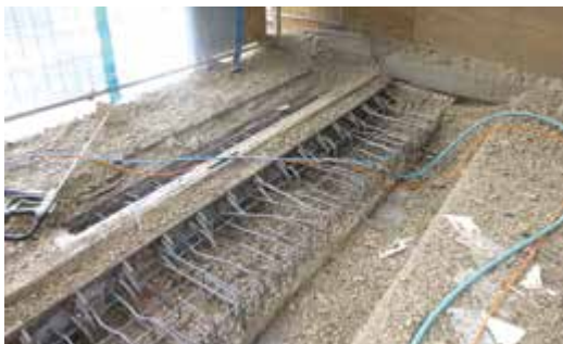
3. Die Folge: massiv geschädigter Auflagerbereich.
