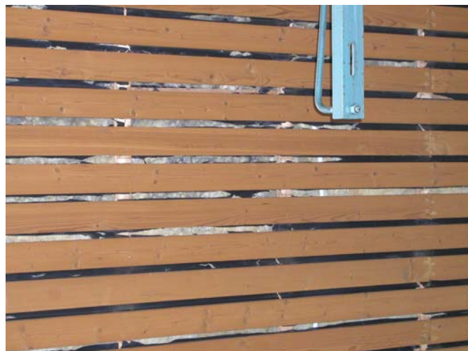
Turnhallendecke mit heraushängender Mineralfaser
