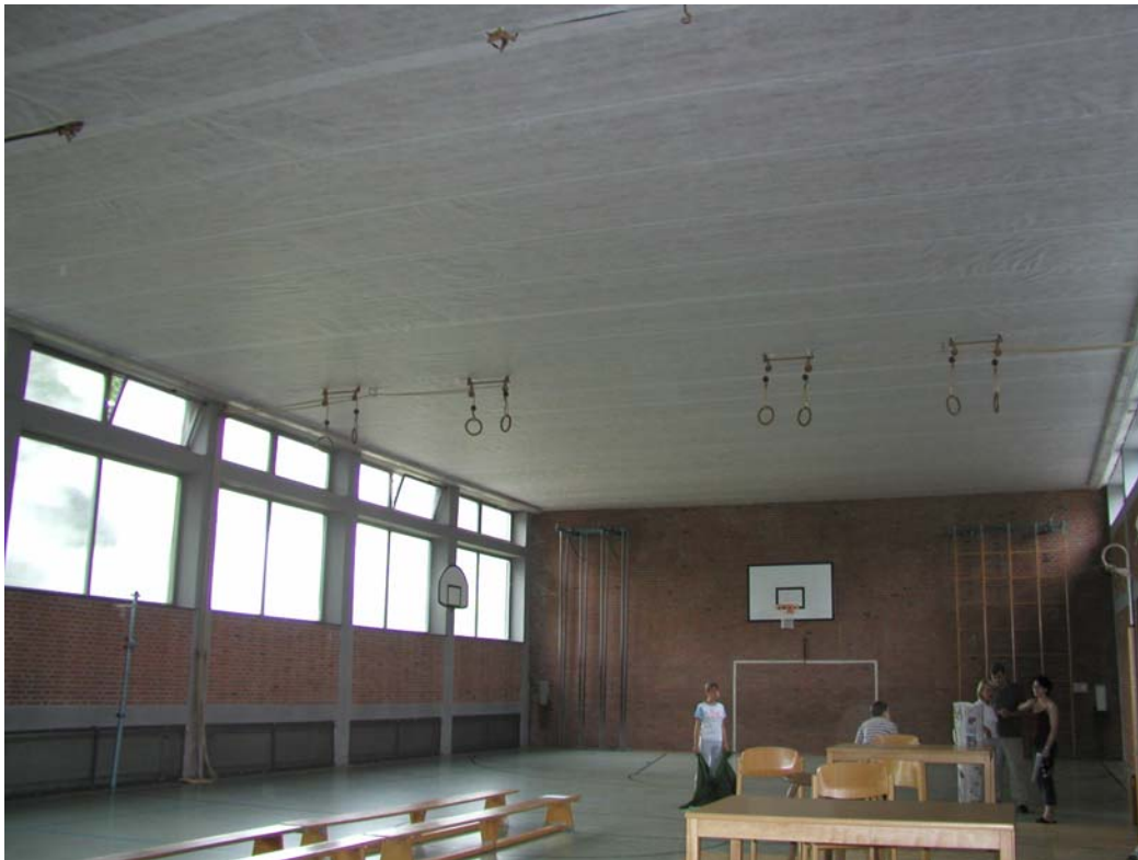
Turnhallendecke mit Interimsmaßnahme (Einhausung der Decke)
