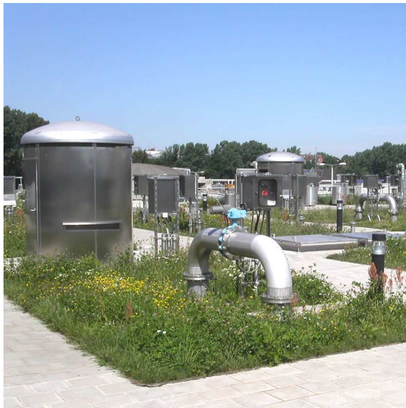
Die Oberfläche der Belebungsbecken mit den Antrieben der Kreisellüfter.
