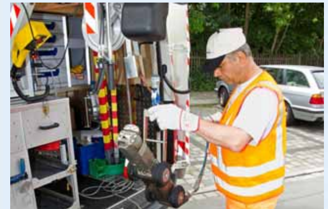
Mitarbeiter des Kanalbetriebs bei der Arbeit: Hochdruck-Spülfahrzeug und Kanalfernauge (Fotos: Fotografie Wolfgang Seitz)
