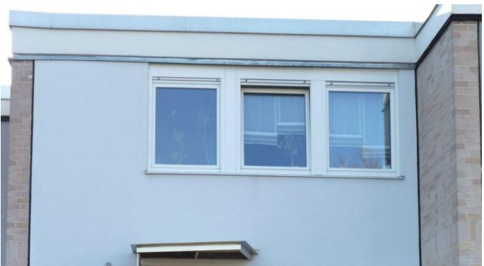
So etwas ist nicht denkmalgerecht
