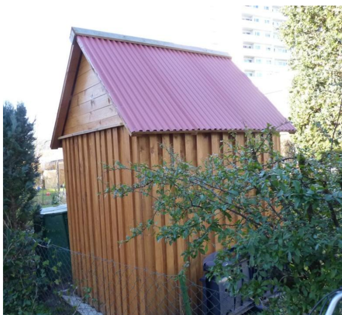
So etwas ist nicht denkmalgerecht
