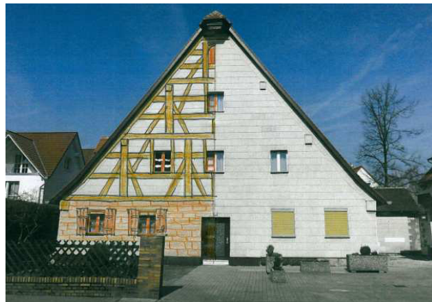
(77) manchmal findet man unter Faserzementplatten aus den 1970er Jahren ein barockes Fachwerk (Animation)
