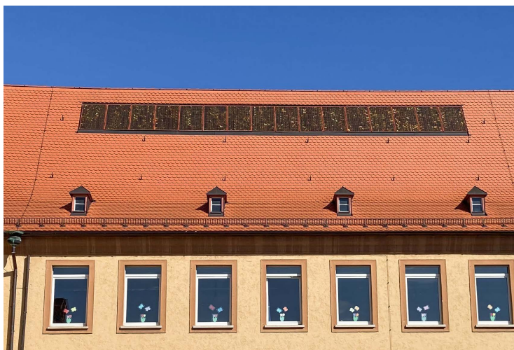
Ensemble Gartenstadt – Regenbogenschule: dachintegrierte PV-Module in rot
