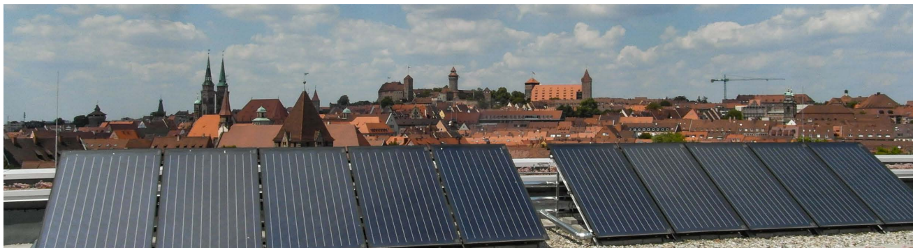
Ensemble Altstadt – Luitpoldhaus: Solarthermieranlage
