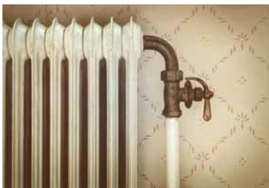
Eine veraltete Heiztechnik kann zu erhöhten Energiekosten beitragen.
