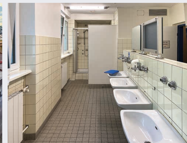
Großweidenmühlstraße 43, Haus für Männer, sanierungsbedürftige Waschräume
