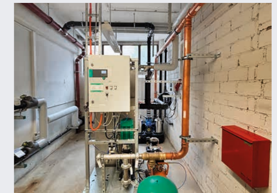
Michael-Ende-Straße 17, Trennung Trink/Löschwassersystem
