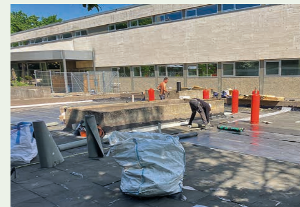
Abdichtung einer Kellerdecke nach Starkregenereignis
