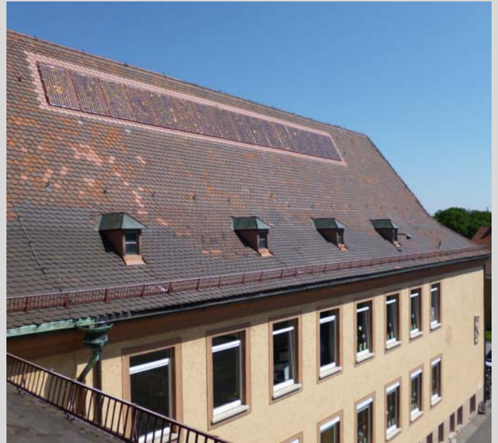
Bild 5: PV-Anlage auf der Regenbogenschule
