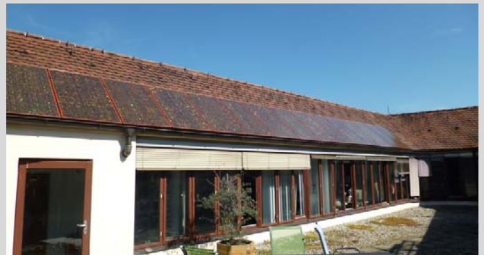
Bild 3: PV-Anlage auf dem Neuen Rathaus, Hauptmarkt 18
