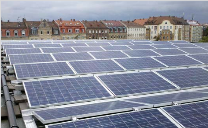
Bild 1: PV-Anlage auf dem süd.stadt.bad mit 76 kW peak
