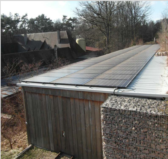
Bild 5: PV-Anlage mit 22 kWp auf dem Loksuppen "Kleiner Adler" im Tiergarten
