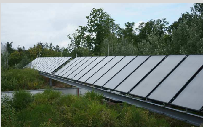
Bild 2: Thermische Solaranlage Tiergarten
