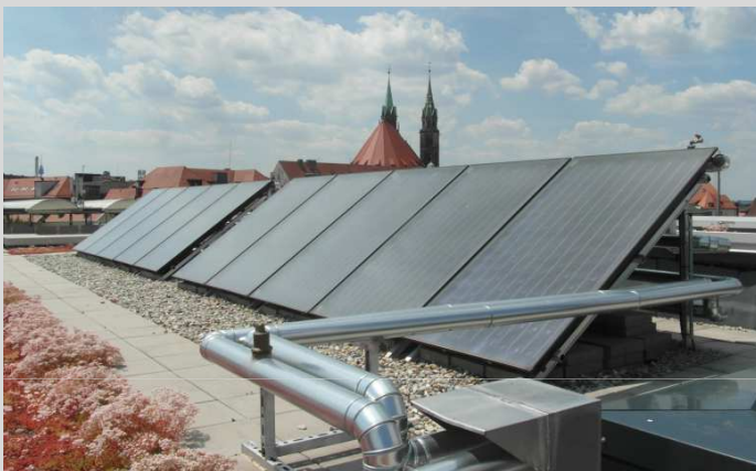
Bild 1: Thermische Solaranlage Luitpoldhaus
