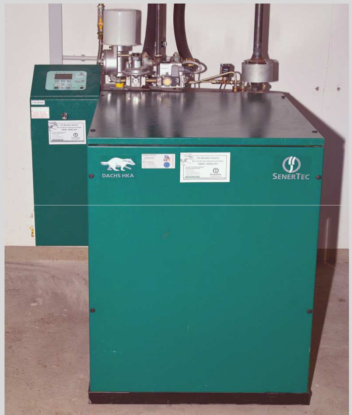
Bild 7: Blockheizkraftwerk im Affenhaus, Tiergarten
