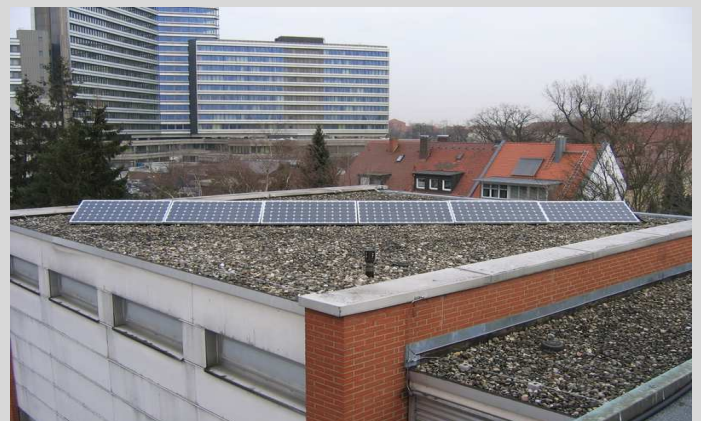
Bild 4: Fotovoltaikanlage Neues Gymnasium
