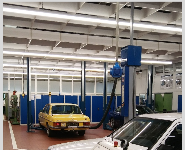
Bild 3: KFZ-Werkstatt mit neuen LED-Leuchten im Bauteil B
