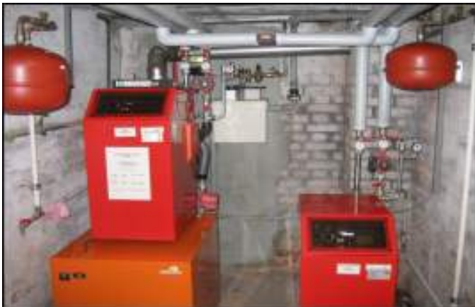
Bild 4: Beide Heizkessel mit nun geöffneter, ursprünglicher Not-Verbindungsleitung
