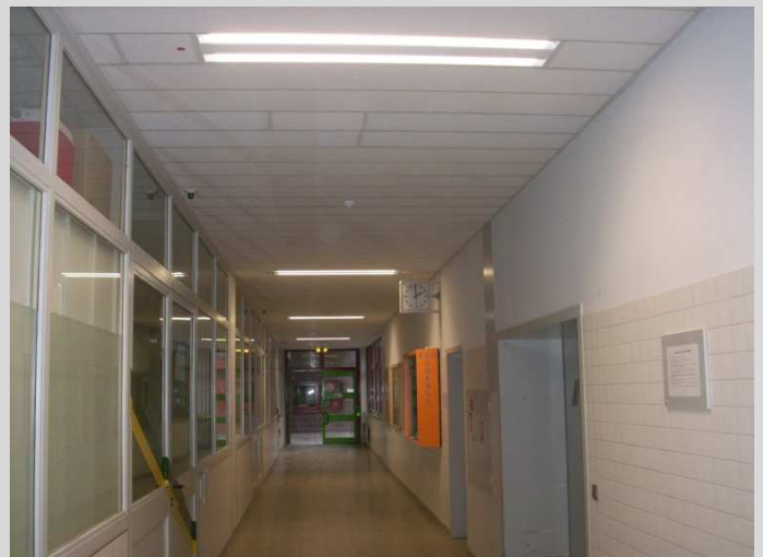
Bild 3: Flur mit neuen LED-Leuchten im Bauteil G
