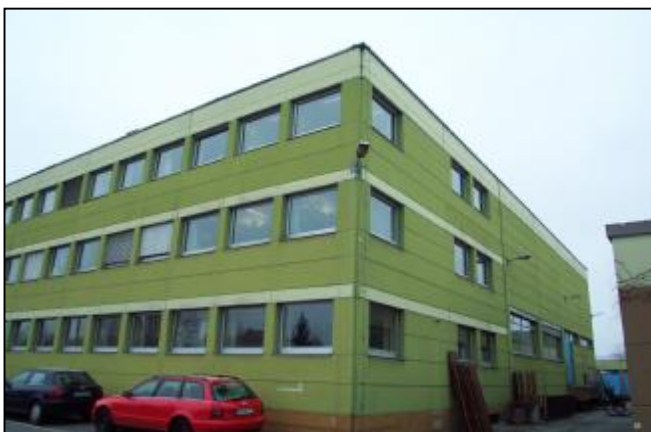
Bild 2: Fassade vor der Sanierung
