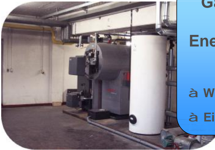
Bild 1: Klein-BHKW und Gas-Brennwert-Heizung, Betriebsgebäude Tiefbauamt, Nürnberg, Donaustr. 90
