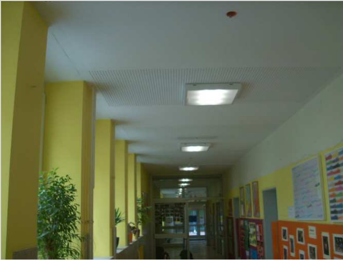
Bild 4: Flur mit LED-Leuchten
