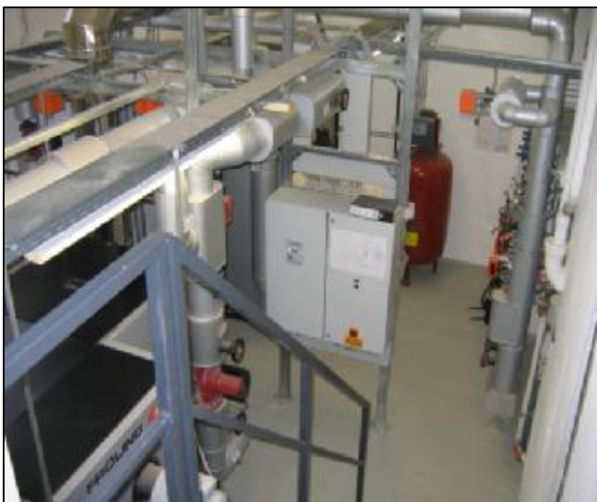
Bild 5: Heizzentrale des Verwaltungsgebäudes nachher: Pelletskesselanlage mit Pufferspeicher und Verrohrung.
