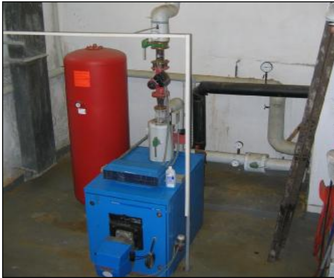
Bild 4: Heizzentrale des Verwaltungsgebäudes vorher: Ölkesselanlage mit dem Heizkreis „Heizkörper Verwaltung“.
