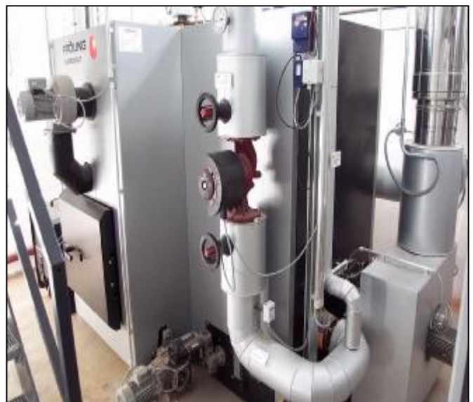
Bild 2: Die Holzpelletsheizkesselanlage mit Brennkammer, Wärmetauscher und Kesselpumpe.
