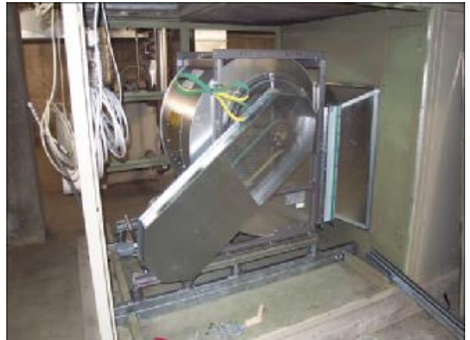
Bild 2: Neu montierter Abluftventilator Sporthalle; ausgestattet mit rückwärts gekrümmten Schaufelrad, Flachriemenantrieb und Motor für Betrieb mit stufenloser Frequenzumformersteuerung.
