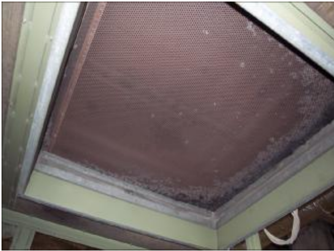
Bild 3: Mittlerweile ausgebaut: Lochblechgitter zur Luftmengenreduzierung.
