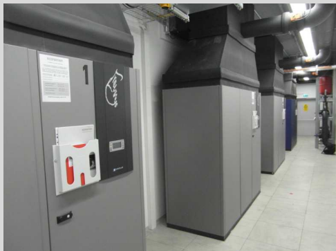
Bild 3: Klimaschränke an der Trennwand zum Rechnerraum
