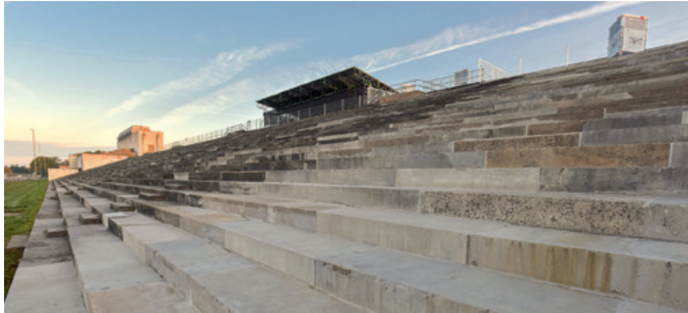
Die Stufenanlage der Zeppelintribüne nach der musterhaften Bearbeitung (siehe Bildvordergrund). Der Gesamteindruck bleibt erhalten.
