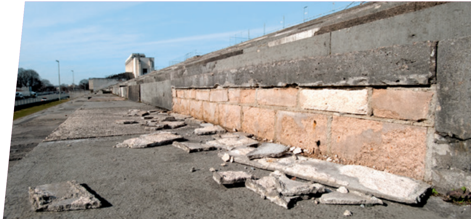
An vielen Stellen lösen sich auf den Stufen der Zeppelintribüne Mauerverblendungen.
