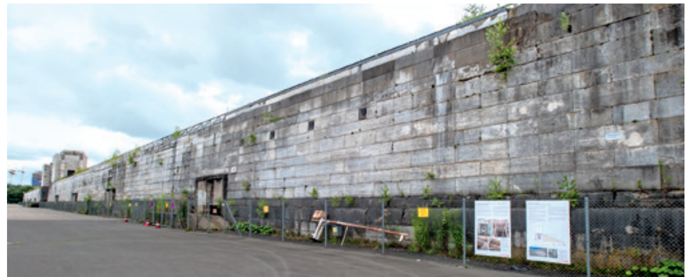
Zäune entlang der kompletten Rückseite der Zeppelintribüne schützen Passanten vor herabfallenden Fassadenteilen.
