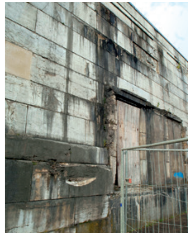
Die Feuchtigkeitsschäden sind überall an der Außenfassade des Gebäudes sichtbar.
