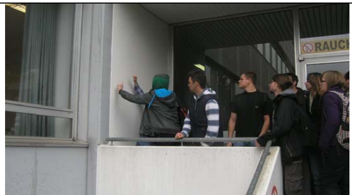
Ist die Wand isoliert oder nicht – Nein, wie der Klopfest beweist.
