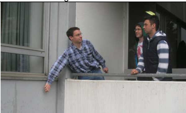
Hinweis auf fehlende Isolierung und eine einfache Möglichkeit wie man dieses feststellt durch Jürgen Uhl (Klopfest)
