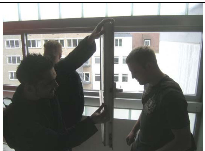
Feststellung, dass die Isolierung der Fenster sehr schlecht ist (Klasse 12 TE)
