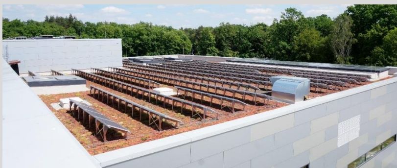
Photovoltaik-Anlage mit Dachbegrünung auf dem Langwasserbad, seit 2015 in Betrieb
