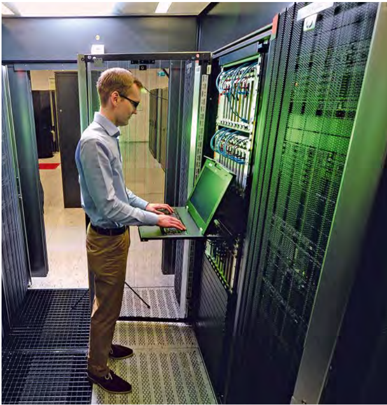
Arbeiten im Allerheiligsten: Techniker Sebastian Schmid im streng gesicherten Datev-Rechenzentrum.
