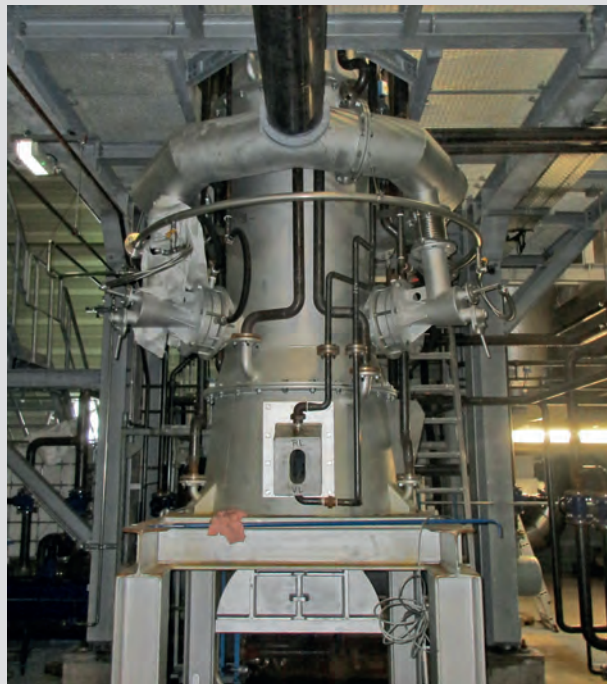
Das Herzstück der Versuchsanlage: Der Reaktionsofen (Kupolofen), in dem der Klärschlamm geschmolzen wird. Hier ein Blick auf die Abstichöffnung. (Foto: KSVN)
