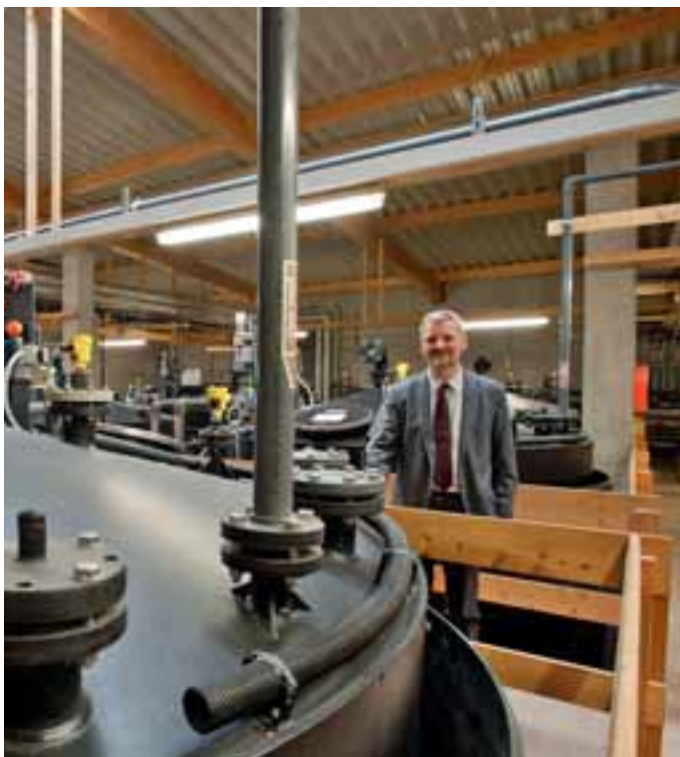
Jäklechemie-Chef Robert Späth ist stolz auf das neue Chemikalien-Tanklager.
