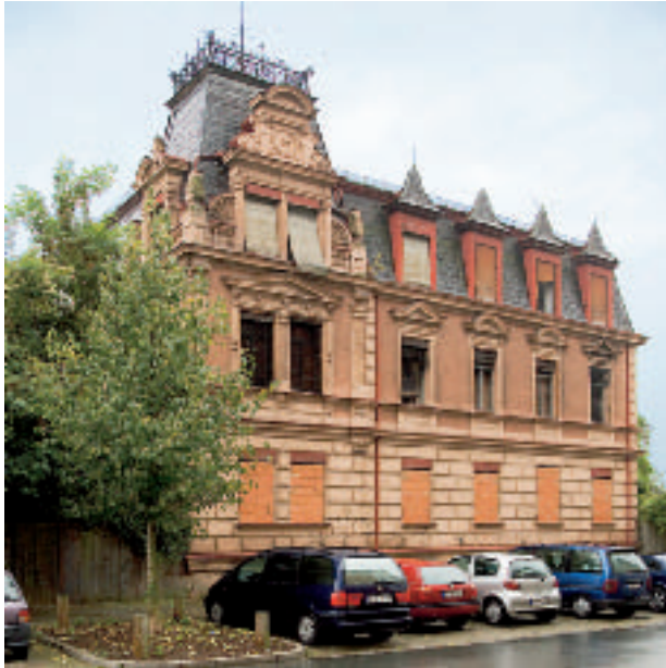
Verfall der ehemaligen „Fabrikanten-Villa“ von 1887...
