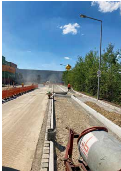
Die Straßenbauarbeiten erfolgten von Mitte Juni bis Mitte Dezember 2020. Abschließend wurden an zwei Wochenenden die neuen Asphaltdeckschichten eingebaut.
