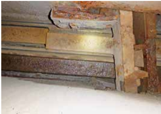
2. Die Konstruktion war komplett korrodiert (Ansicht von unten).
