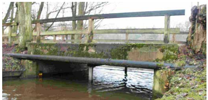
Baufälliges Brückenbauwerk mit Brückenunterstützung 2013
