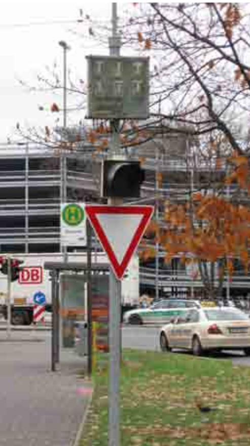
Ausgangszustand LSA Bahnhofstraße/ Dürrenhofstraße, alter Relaiskasten
