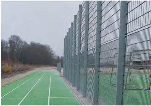
Ballfangzaun – als Einfriedung Allwetterplatz, Stahlgittermatten, Höhe ca. 6,0m
