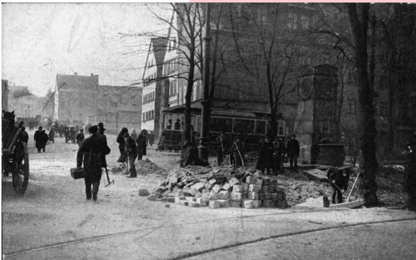
Die Pflasterung am Maxplatz wird wiederhergestellt. Im Hintergrund verkehrt bereits wieder die Straßenbahn, Postkarte 1909. (StadtAN A 34 Nr. 3751)
