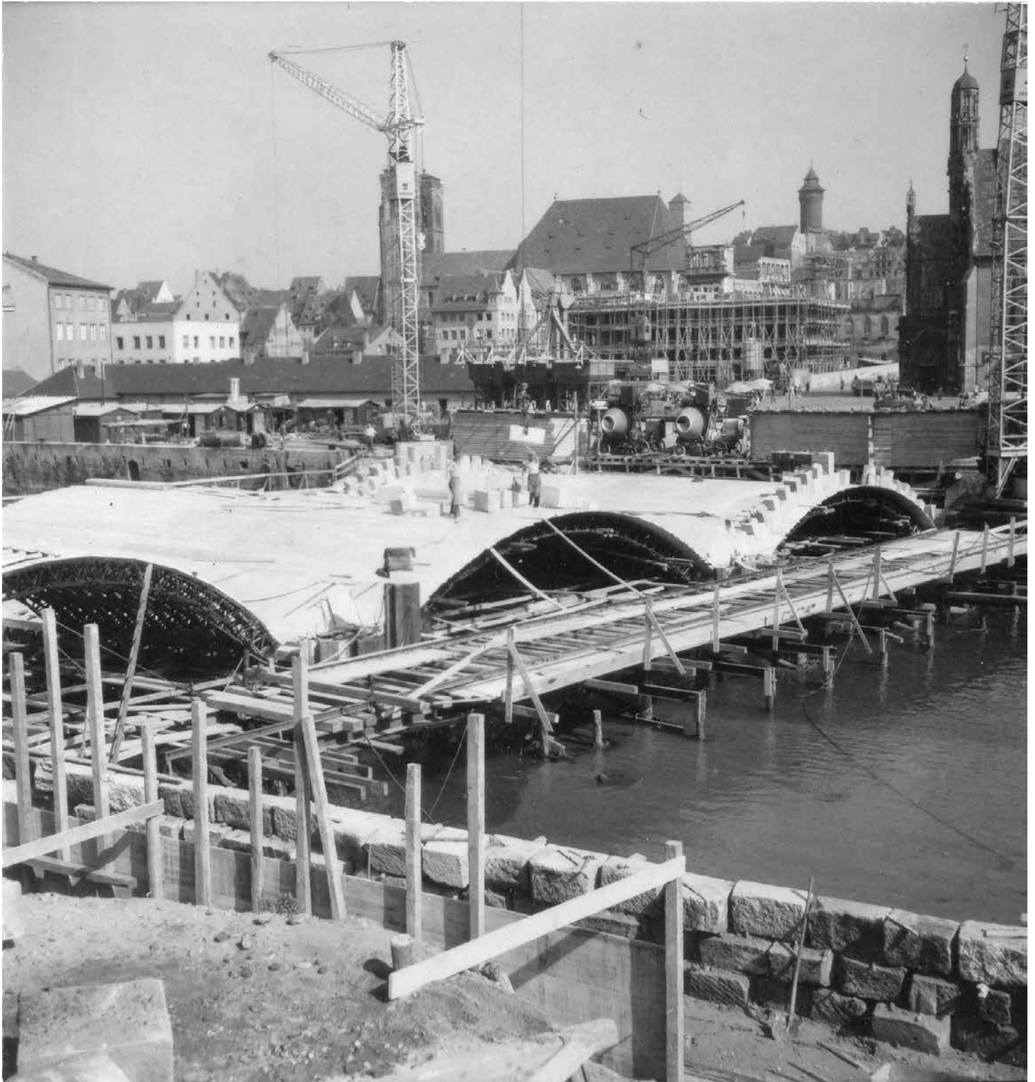
Die Museumsbrücke während der Arbeiten zum Hochwasserstollen 1954. (StadtAN A 39/III Fi M 587)
