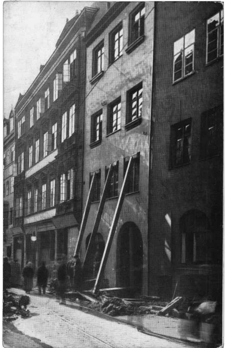
Ein unterspültes Haus musste in der Winklerstraße abgestützt werden, Postkarte 1909. (StadtAN A 41 LR 850/10)
