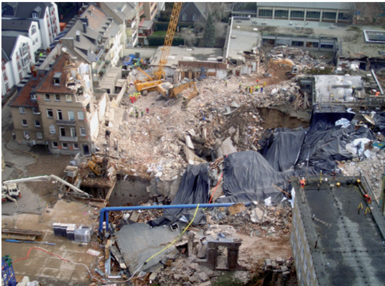
Die Einsturzstelle, Luftaufnahme Jürgen Schütze 7.3.2009. (Berufsfeuerwehr Köln)
