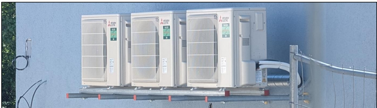
Abbildung 4. Außengeräte an der Ostfassade des Unterwerks
