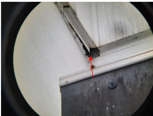
Foto 5: Spalte am ehem. Realgebäude, potentielle Fledermausquartiere.
