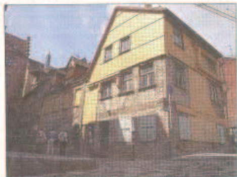
Total verfallen: In einem aufwendigen Sanierungs-Projekt werden diese alten Häuser jetzt als Museum hergerichtet. Foto: Benny Meyer
