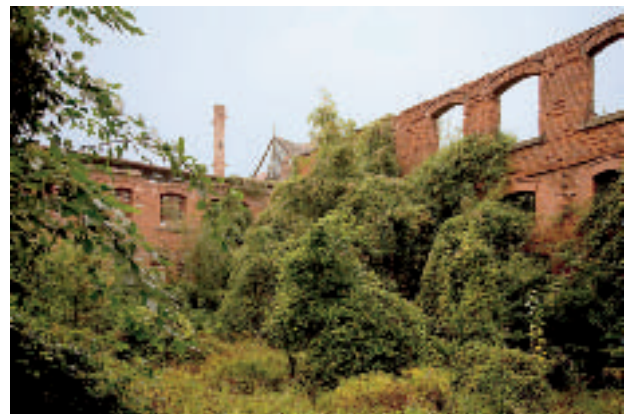
... und die restlichen Bauruinen.
