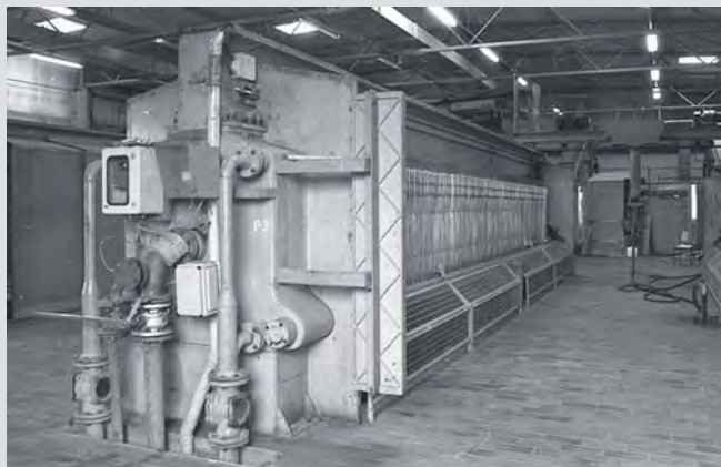
Bilder aus der ersten Schlammmentwässerungsanlage. Ganz oben ein Druckbehälter der Schlammkonditionierung, darunter ein Blick auf die Filterpressen.
