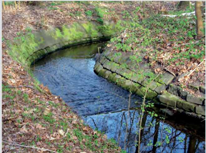
Oben: Massiver Uferverbau verhinderte die natürliche Entwicklung des Langwassergrabens.
