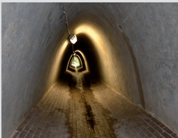
Sturmauslass Nördlicher Hauptsammler, Auslaufkanal.
