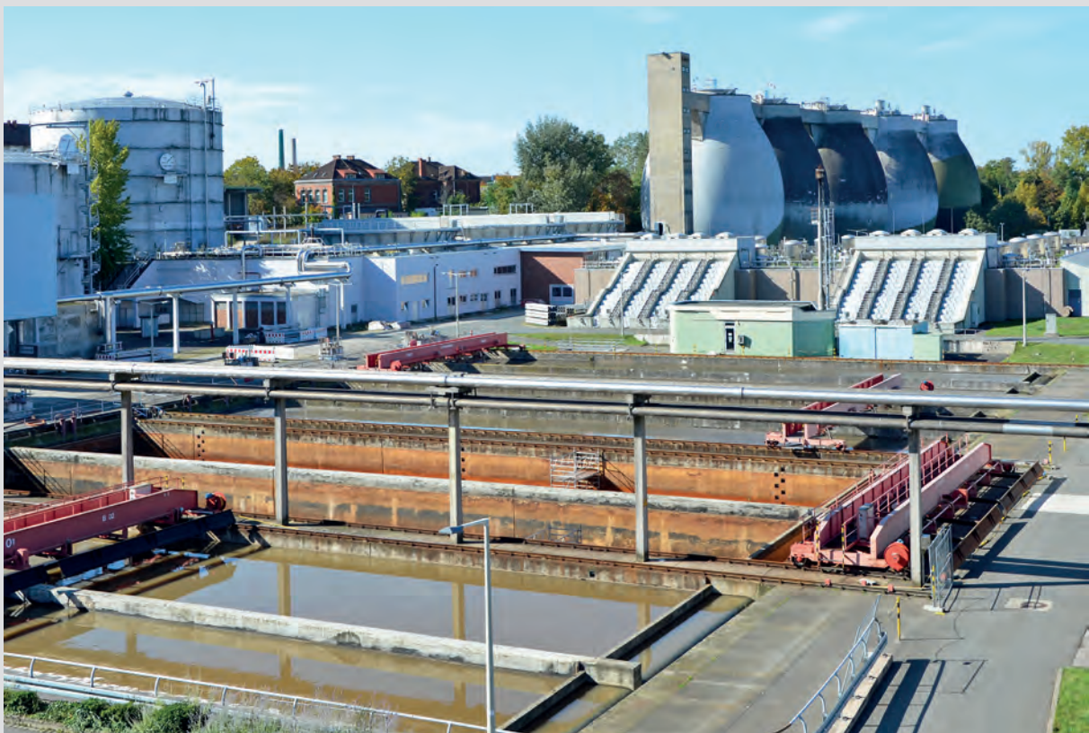
Ein Blick auf das Klärwerk 1: Vorklärung, Hochlastbelebungs- und Schlammfaulbehälter. Foto: Susanne Vogel (SUN).
