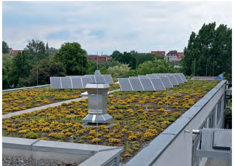
Begrünung eines Flachdachs an einem Gebäude im Nürnberger Klärwerk 1. (Foto: SUN)
