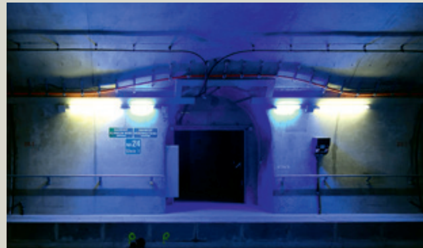
Beleuchteter Notausstieg vom Tunnel aus gesehen.
