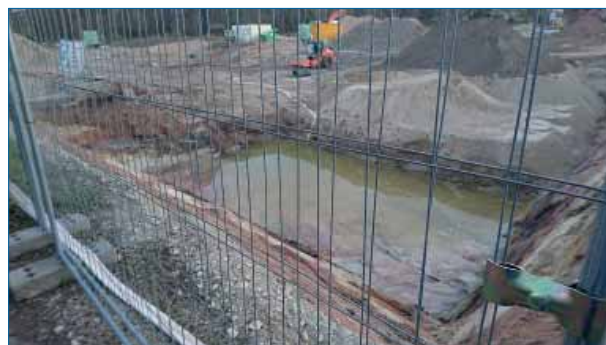
Abbildung 127: Wasser in der Baugrube (Quelle: Stadt Nürnberg, Umweltamt)
