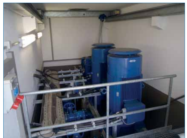
Abbildung 24: Beregnungspumpwerk und Brunnenfassung (Quelle: Wasserverband Knoblauchsland)
