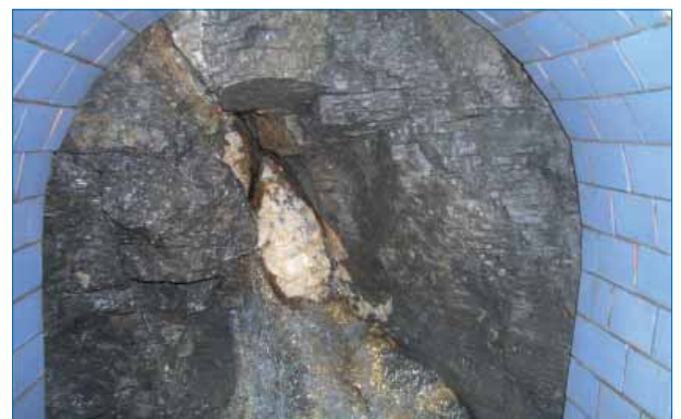
Abbildung 32: Typischer Muschelkalk-Aquifer: Starker Wasseraustritt aus verkarsteter Störungsfläche mit Kluftfüllung; Norbertusheim-Stollen der Trinkwasserversorgung Würzburg. (Foto: BAIER, GeoZentrum Nordbayern der FAU Erlangen-Nürnberg).
