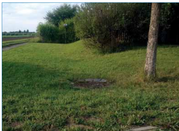
Abbildung 15: Entwässerungsmulde zur Ableitung von Niederschlagswasser vor Ort (Quelle: Stadt Nürnberg, Umweltamt)
