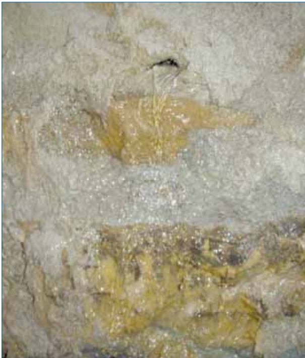
Abbildung 38: Wasseraustritt über „Quacken“horizont aus Klüften im Blasensandstein (U-Bahnbau Nürnberg / bergmännischer Vortrieb) (Foto: TÜV Rheinland LGA Bautechnik GmbH)
