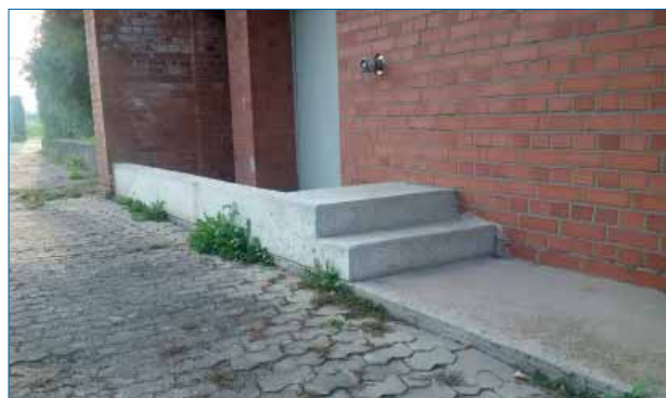
Abbildung 17: Hochwasserschutz an Bauwerk (Quelle: Stadt Nürnberg, Stadtentwässerung und Umweltanalytik Nürnberg)
