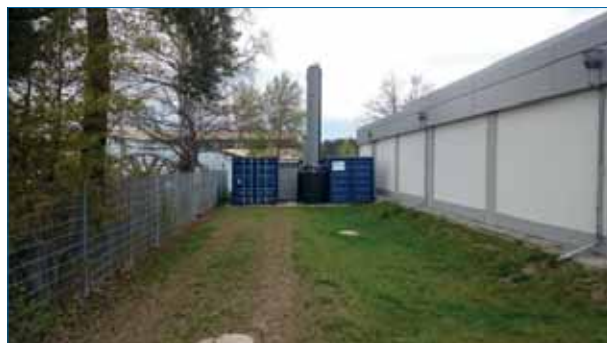
Abbildung 123: Sanierungsanlage neben Lebensmitteldiscounter (Quelle: Stadt Nürnberg, Umweltamt)
