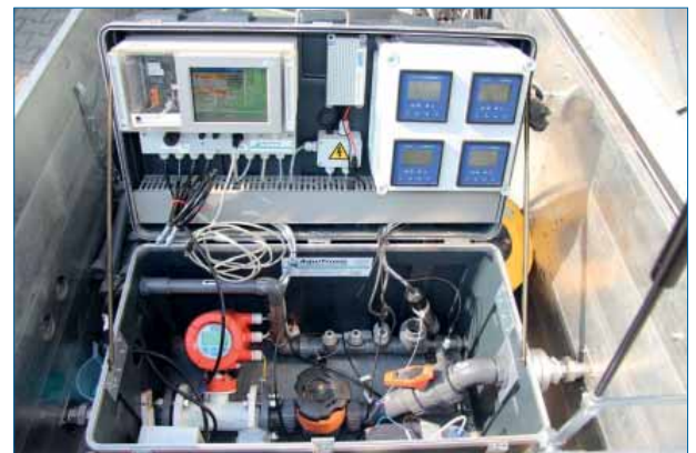
Abbildung 64: Pump Box (Quelle: Stadt Nürnberg, Stadtentwässerung und Umweltanalytik Nürnberg)
