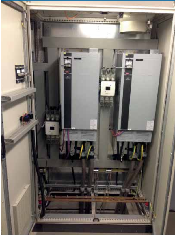
Abbildung 29: Schaltanlage mit Frequenzumrichter (Quelle: Wasserverband Knoblauchsland)
