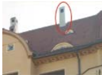
Durch eine Kaminattrappe verborgene Mobilfunkantenne
