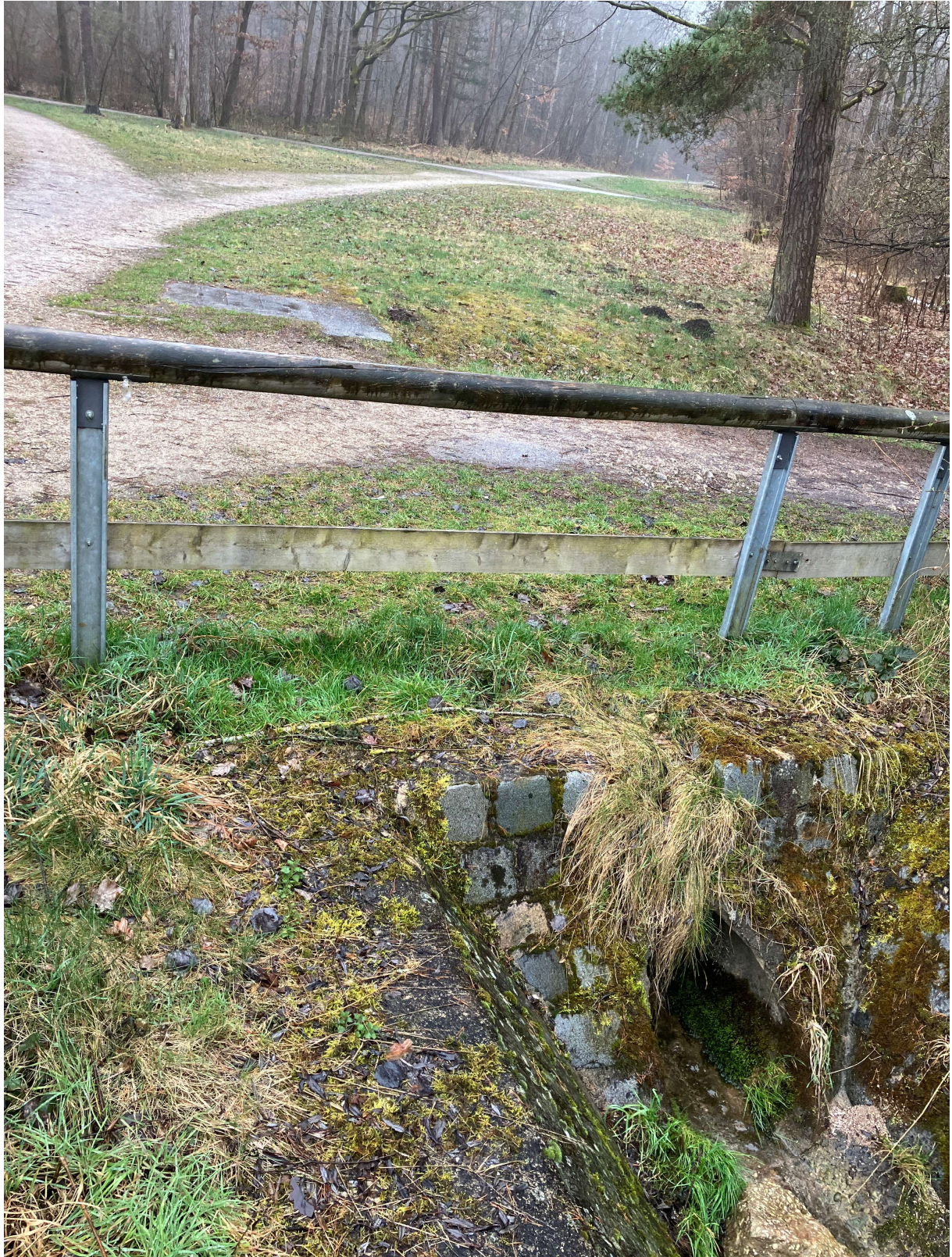
Auslauf der Entleerungsleitung des Hochbehälters Hoher Bühl
