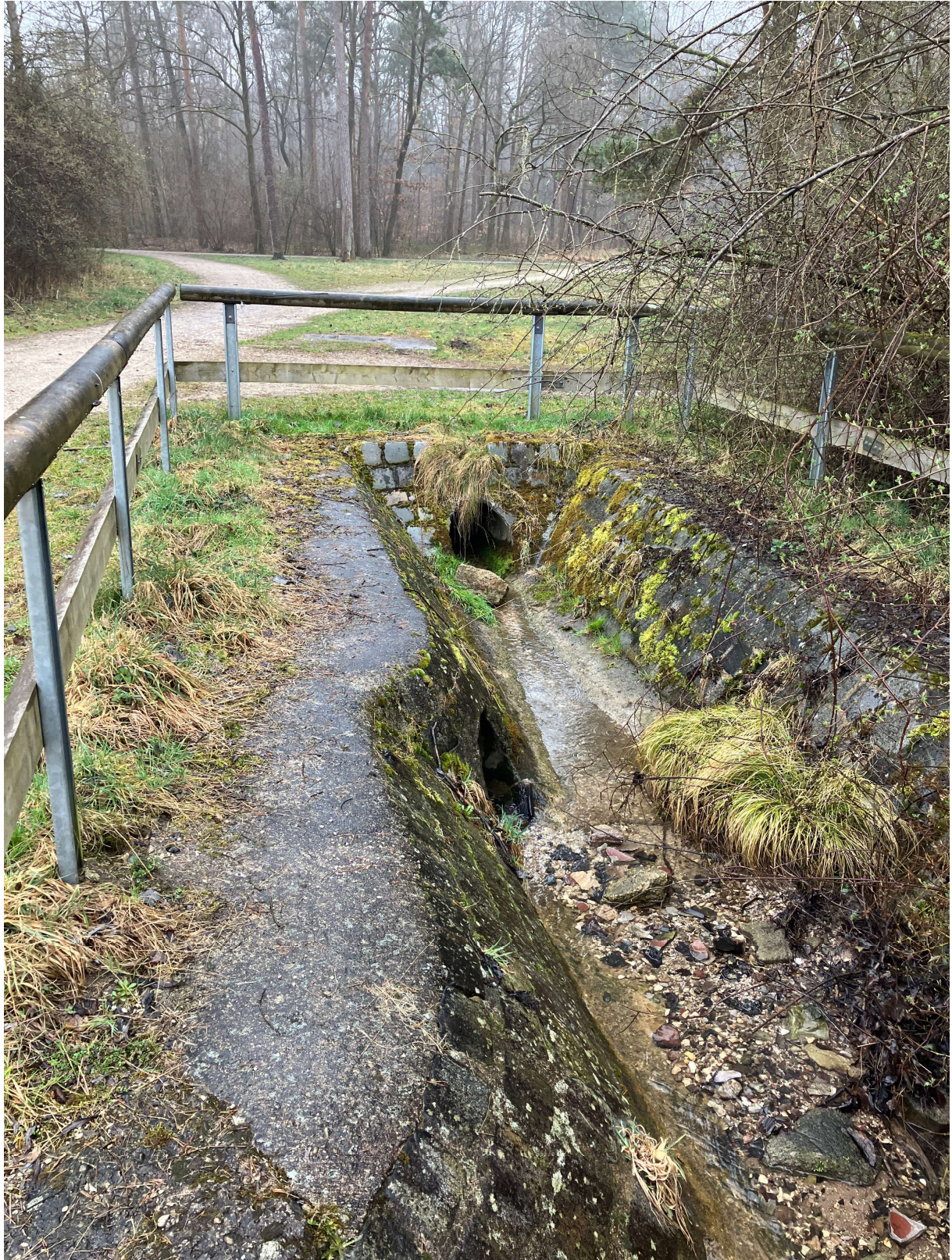
Auslauf der Entleerungsleitung des Hochbehälters Hoher Bühl (im Bild oben) mit Auslaufbauwerk
